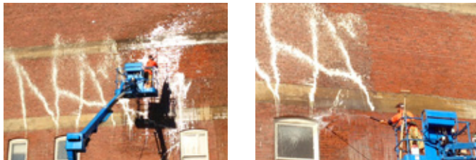
Elimina el aerosol de pintura realizados con extintores
