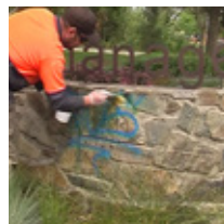
Spraya azul en muro protegido. Aplicar BBSM.
